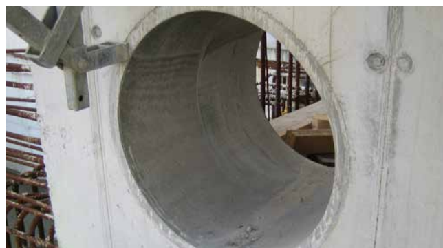
FZR400/300 inbouwlocatie zuiveringsinstallatie
